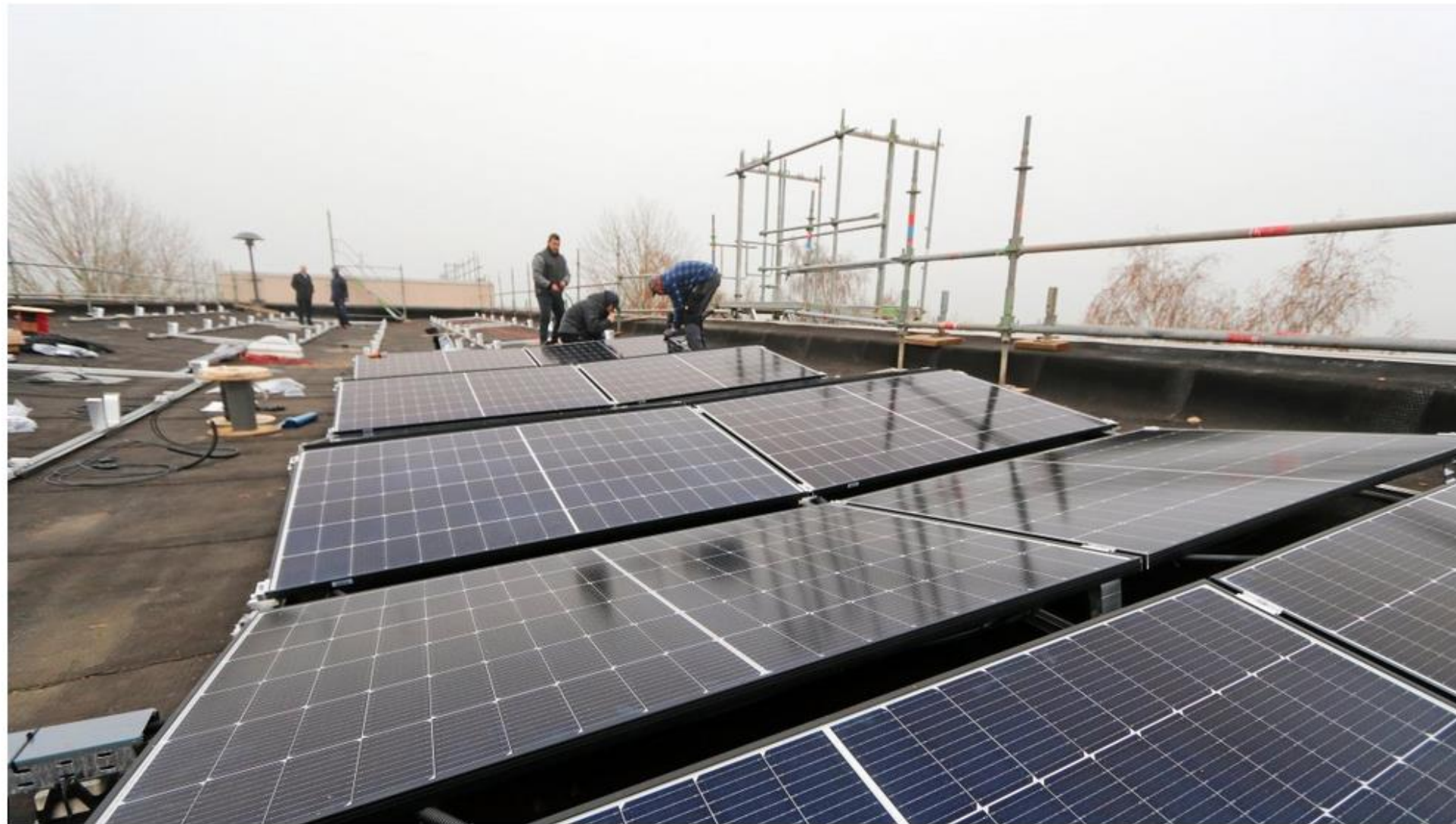
Solarflächenbau auf einem Dach (Symbolbild).
