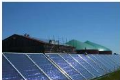
16,67 kWp Stadtwerke Wanzleben
